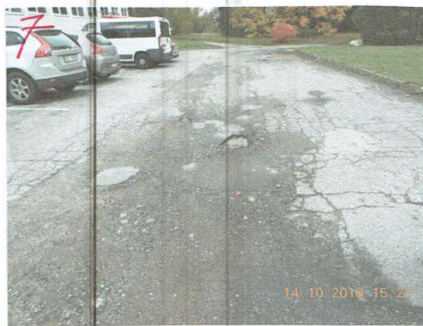
FASADES C-D A/M STĀVLAUKUMĀ ASFALTA SECUMIS NOLĪETOJĀS.
