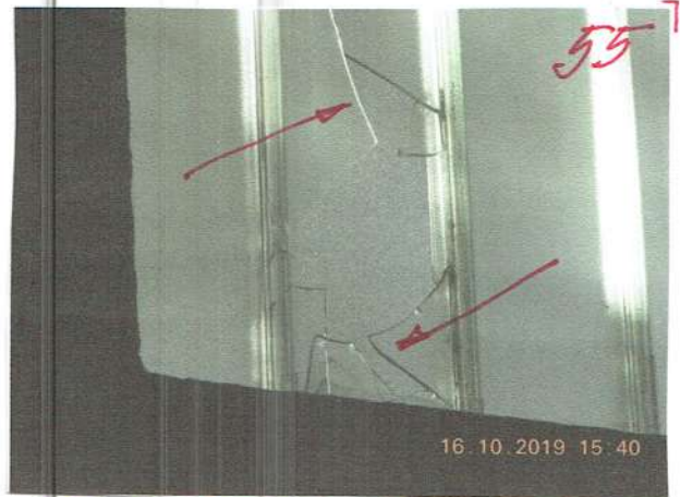
55 NAV PĀBEIGTA LOGU AĻU FRĒŽĒ ĀDĀRE. ĪTIKĻA BĻOKU BOJĀJUMI - 12BĪRUMI
