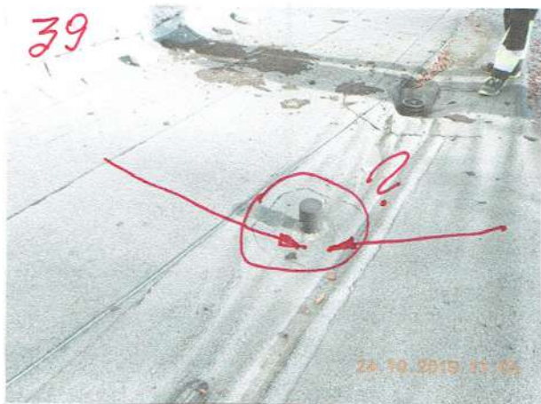
JUNTA VENTILĀCIJAS IZVADI IEBŪVĒTI ZEMĀKAJĀ VIETĀ.
