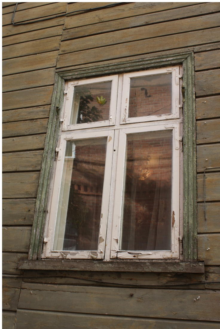
Kaarlja_Miilenbaha_5_88010130085001_logs3 Sākotnēja (19.gs.1.p.) loga aploda. Vērtnes sekundāras, tām izmantots sākotnējo logu aprīkojums.
