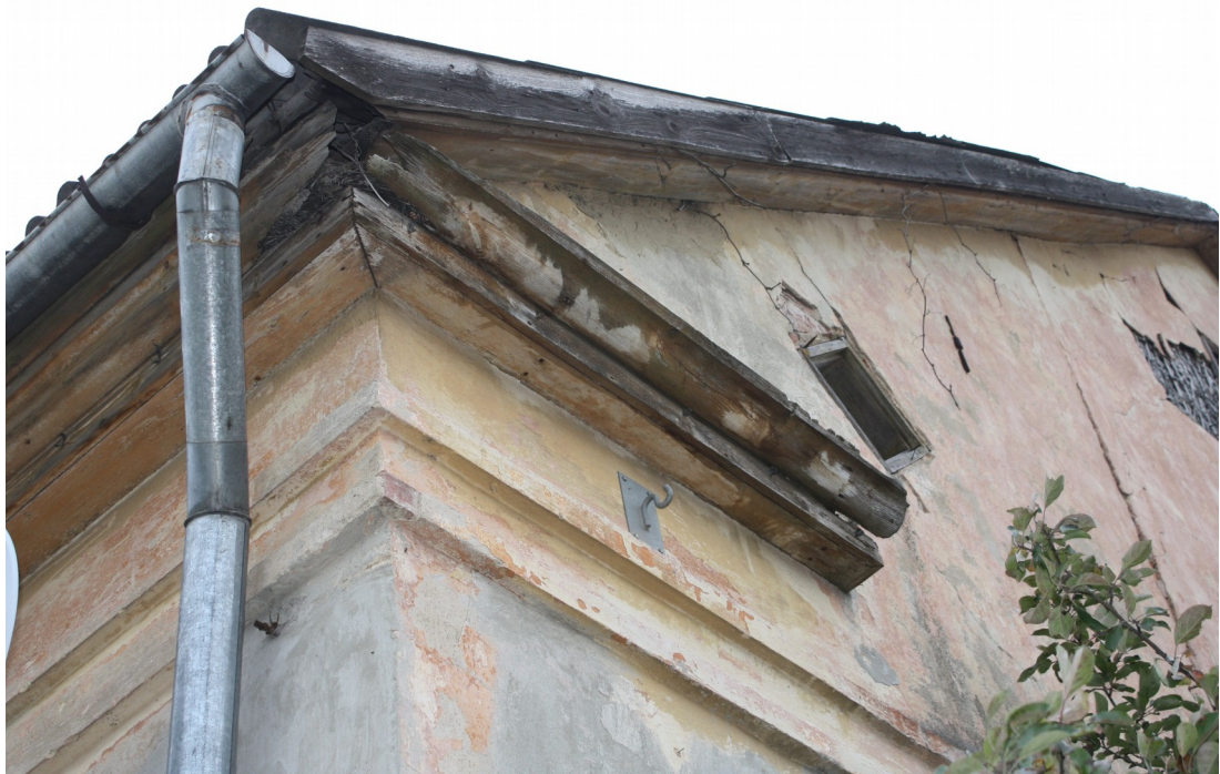
Kaarlja_Miilenbaha_18_88010130017001_fragments2 Sākotnējā (19./20.gs. mija) dēļu dzega un mūra starpdzegas.
