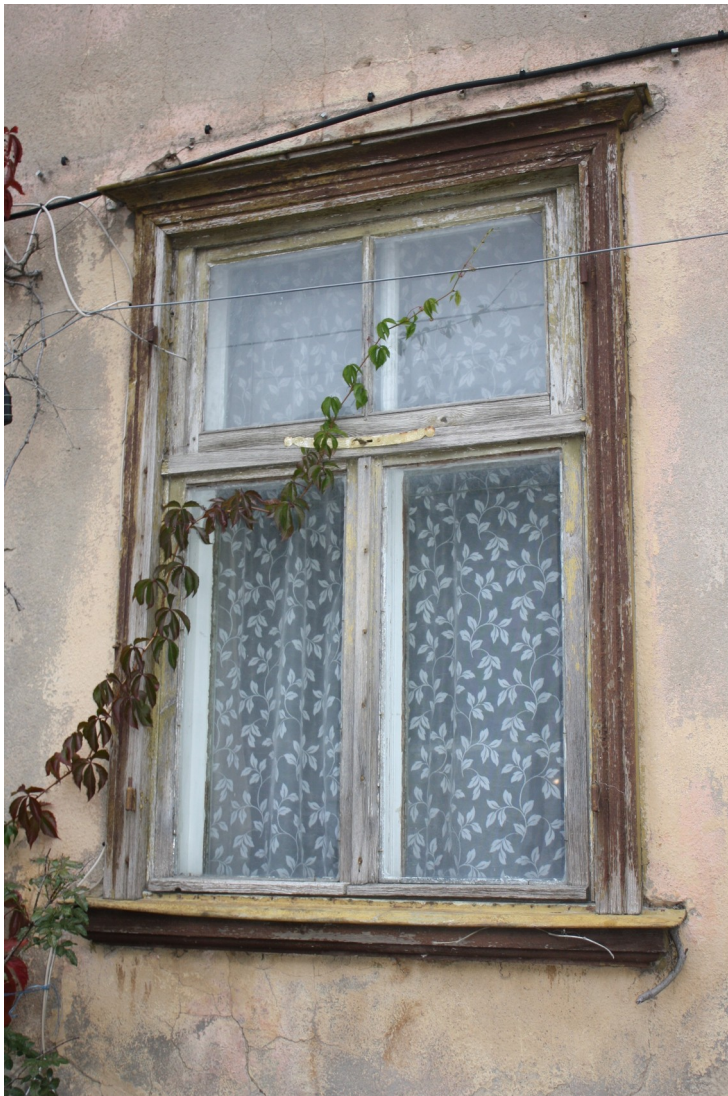
Kaarlja_Miilenbaha_18A_88010130017 002_logs1 Sākotnējs (1931.g.) logs ar oriģinālo logailas apdari. Saglabājušās slēgu stobrviru daļas un atspere.
