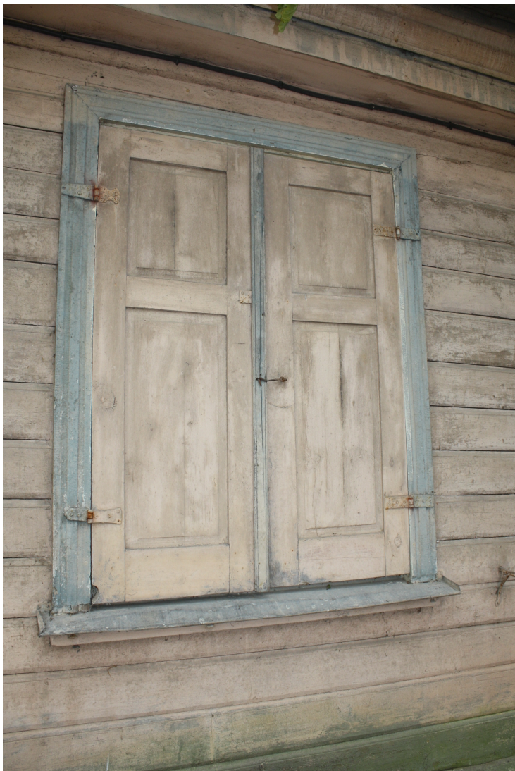
Kalna_3_88010120195001_slegis1 Sākotnējie slēgi ar aprīkojumu.
