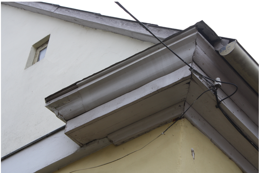
Kalna_5_88010120205001_dzega1 Atjaunotas sākotnējās dzegas fragments.
