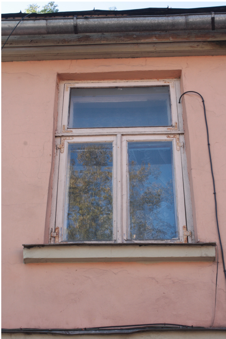
Liela_11_88010090013001_logs1 Sākotnējais logs ielas fasādē. 1900.g.
