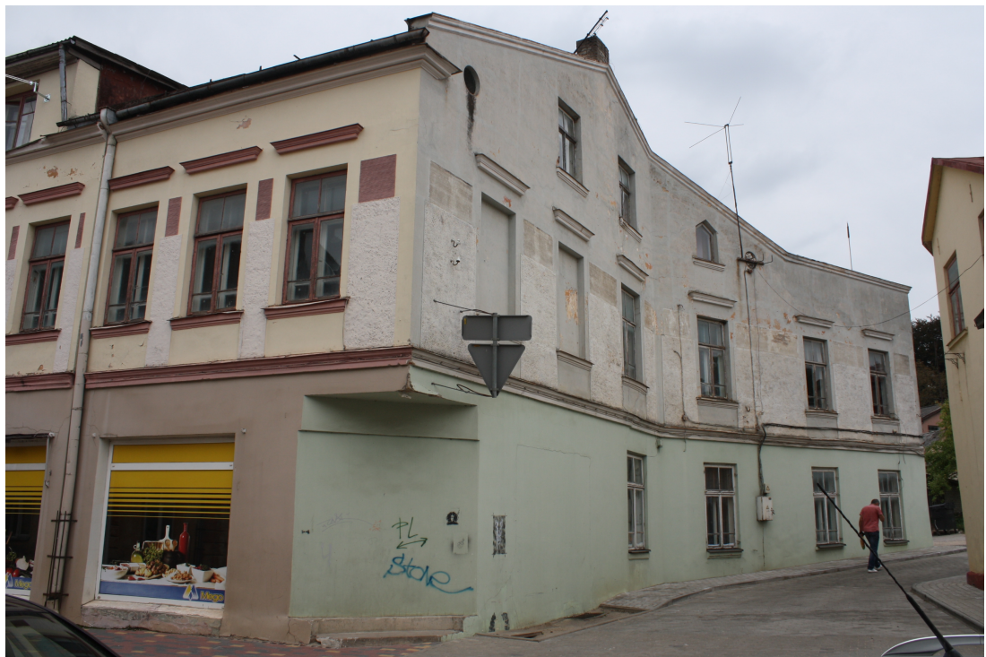
Liela_26_88010120188001_fasade2 Skats uz ēkas gala fasādi no dienvidiem. Gala fasādē likvidēta 20.gs.2.puses vitrīna.
