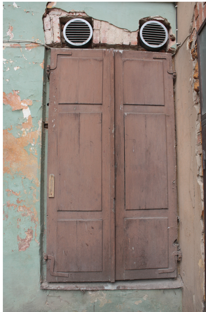
Lielaa_26_88010120188001_slegis1 Sākotnējie slēgi ar aprīkojumu.
