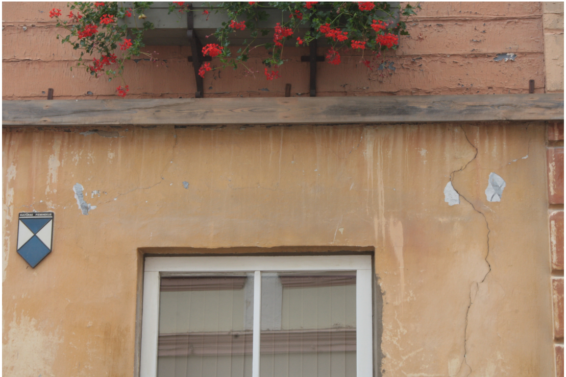
Lielaa_27_88010130140001_detala3 Ielas fasāde ar vēsturiska krāsojuma (domājams, reklāma) fragmentiem.
