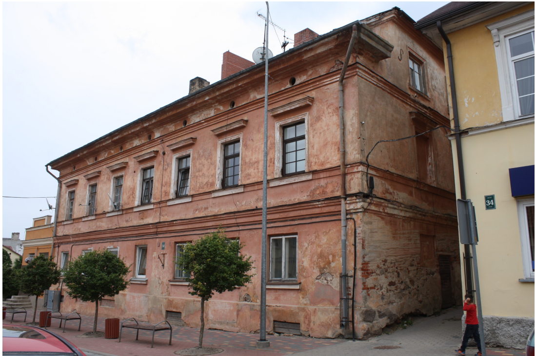
Liela_32_88010120191001_fasade1 Skats uz ēku no dienvidaustrumiem. Fasādē zudis balkons.
