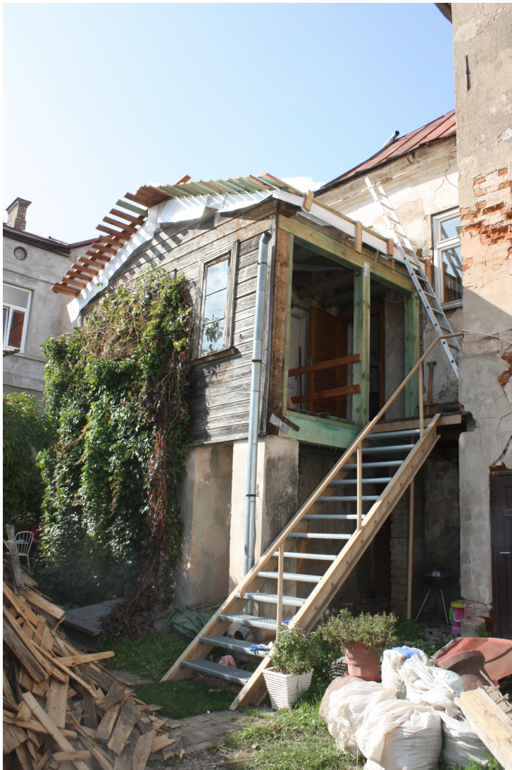
Lielaa_33_88010130006001_ fragments1 Skats uz 19.gs.4.cet. piebūvi dienvīdu (pagalma) fasādei. Norisinās bojāto konstrukciju nomainīšana.
