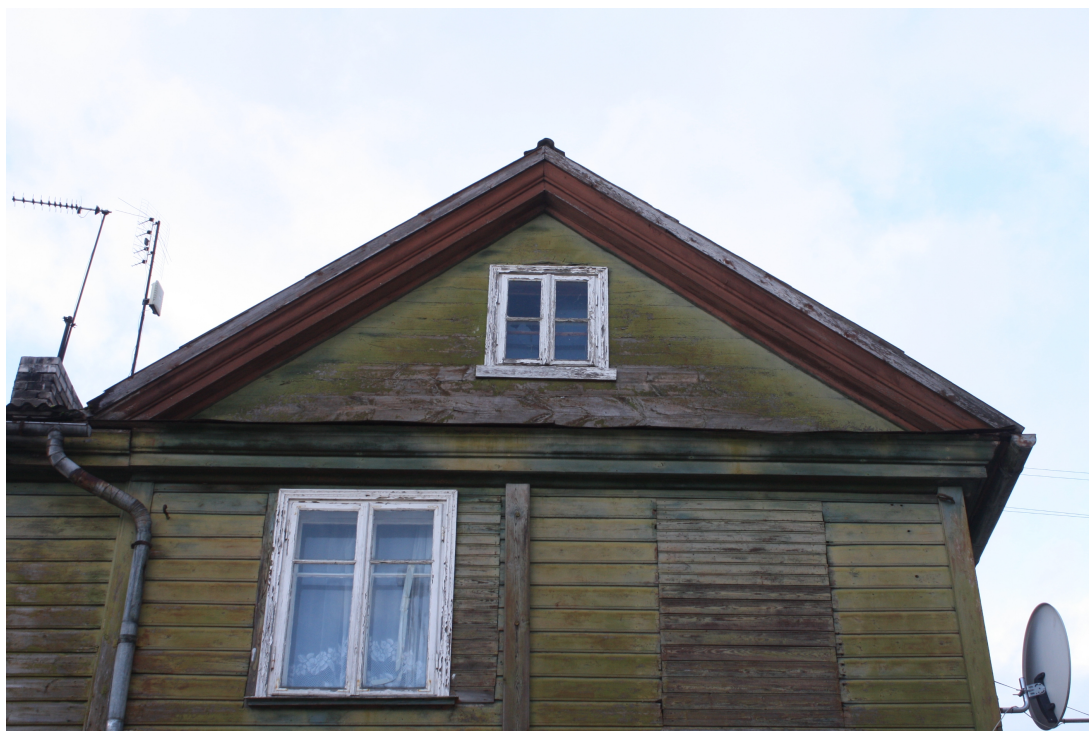
Lielaa_43_88010130083001_fragments1 Skats uz ielas fasādes dienvidu gala frontonu. 20.gs.2.pusē 2.stāvā mainīts loga platums, viena loga likvidēta.
