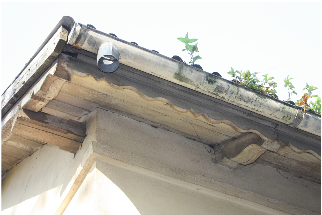
Saules_5_88010130128001_detala1 Sākotnējs (19.gs./20.gs. mijas) dekoratīvi griezts dēlis gar jumta apakšējo malu un dekoratīvi griezti spāru gali.
