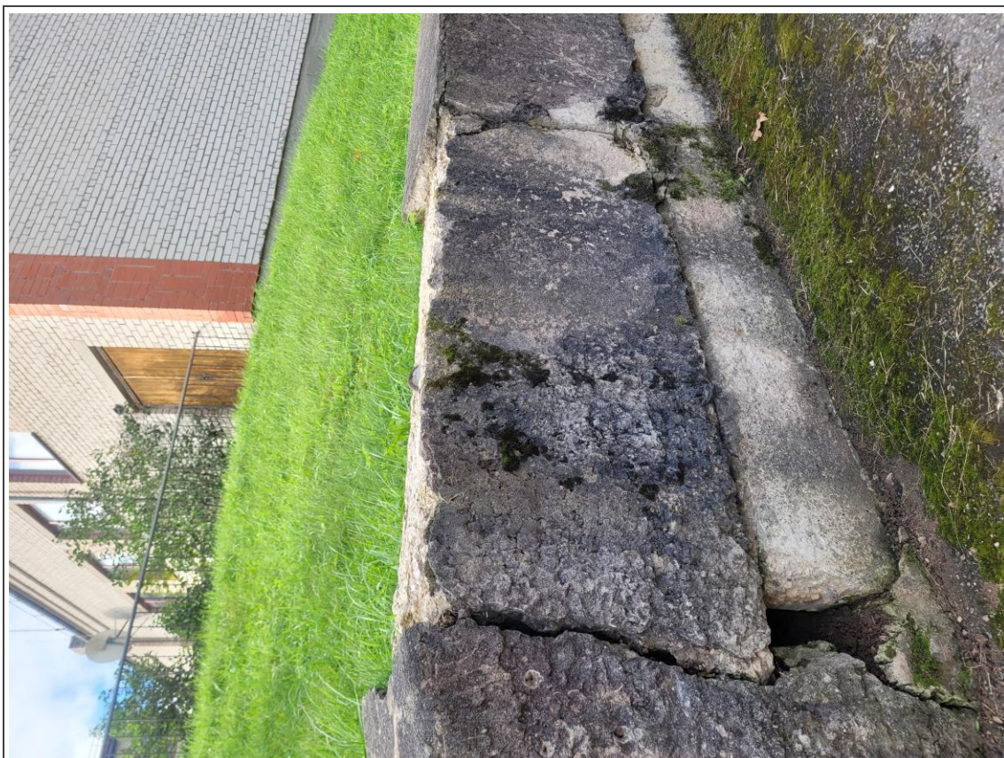
9.attēls. Atbalstsienas pie Talsu 2. vidusskolas, dzelzsbetona bloku šuvu vietās ir caurejošas plaisas.
