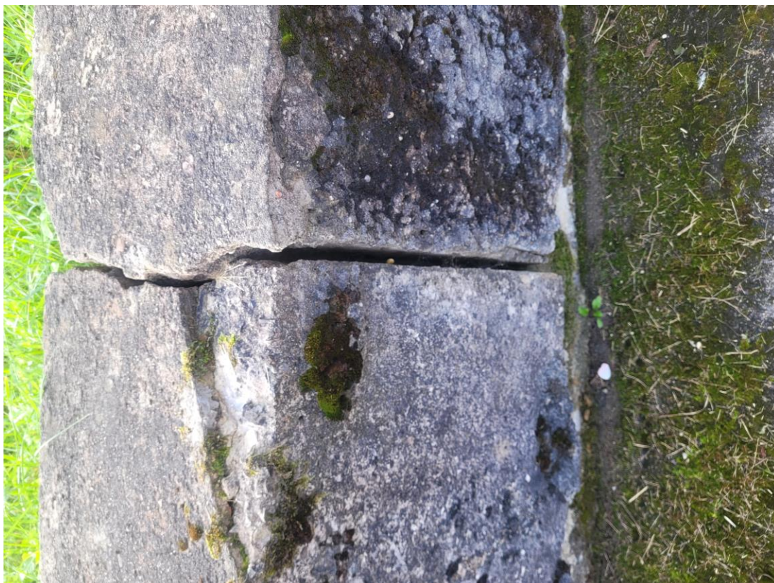
6.attēls. Atbalstsienas pie Talsu 2. vidusskolas, dzelzsbetona bloku šuvu vietās ir caurejošas plaisas.
