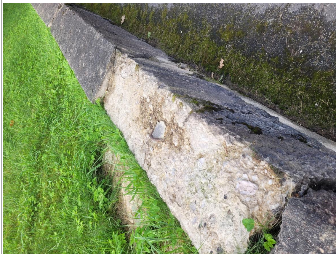
10.attēls. Atbalstsienas pie Talsu 2. vidusskolas, dzelzsbetona bloku šuvu vietās ir caurejošas plaisas.
