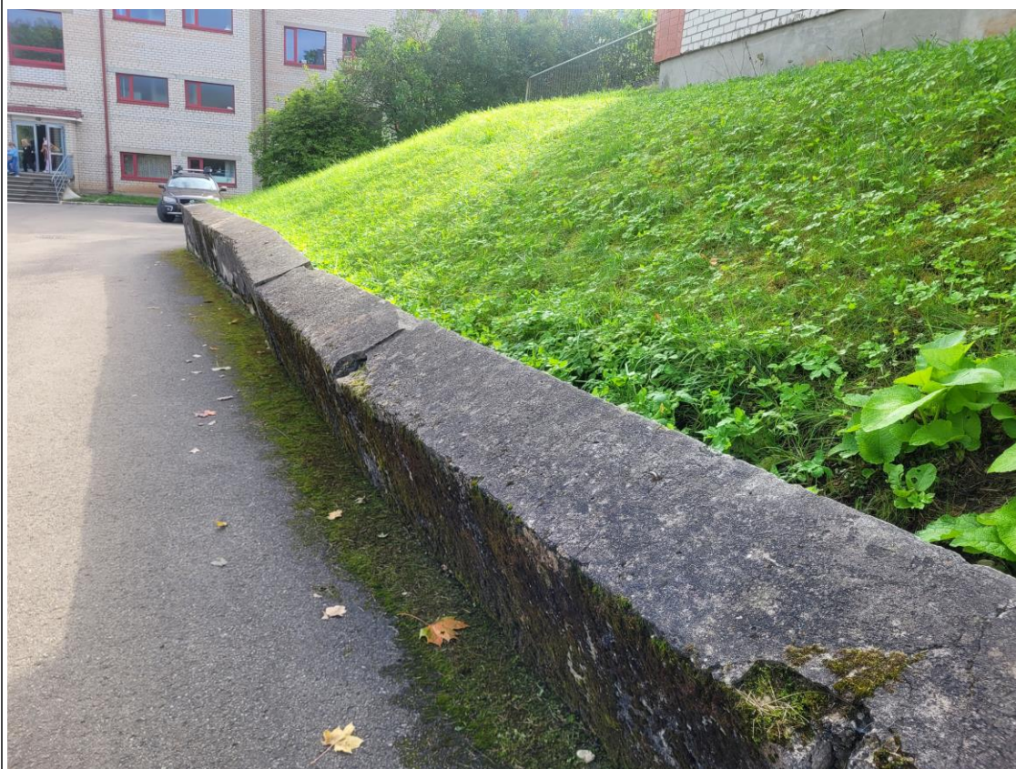
12.attēls. Atbalstsienas pie Talsu 2. vidusskolas, dzelzsbetona bloku šuvu vietās ir caurejošas plaisas. Zemes uzbēruma spiedes rezultātā atbalstsiena ir sagāzusies uz piebraucamā ceļa pusi.
