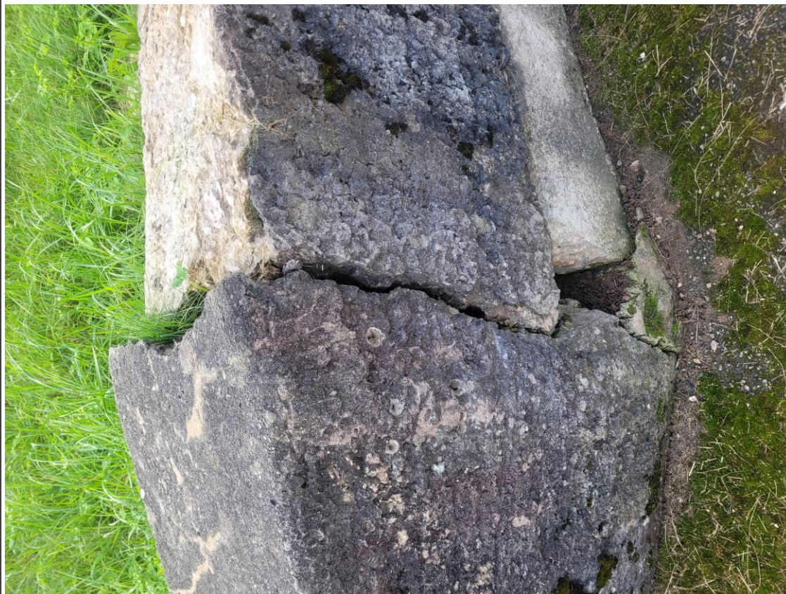
7.attēls. Atbalstsienas pie Talsu 2. vidusskolas, dzelzsbetona bloku šuvu vietās ir caurejošas plaisas.
