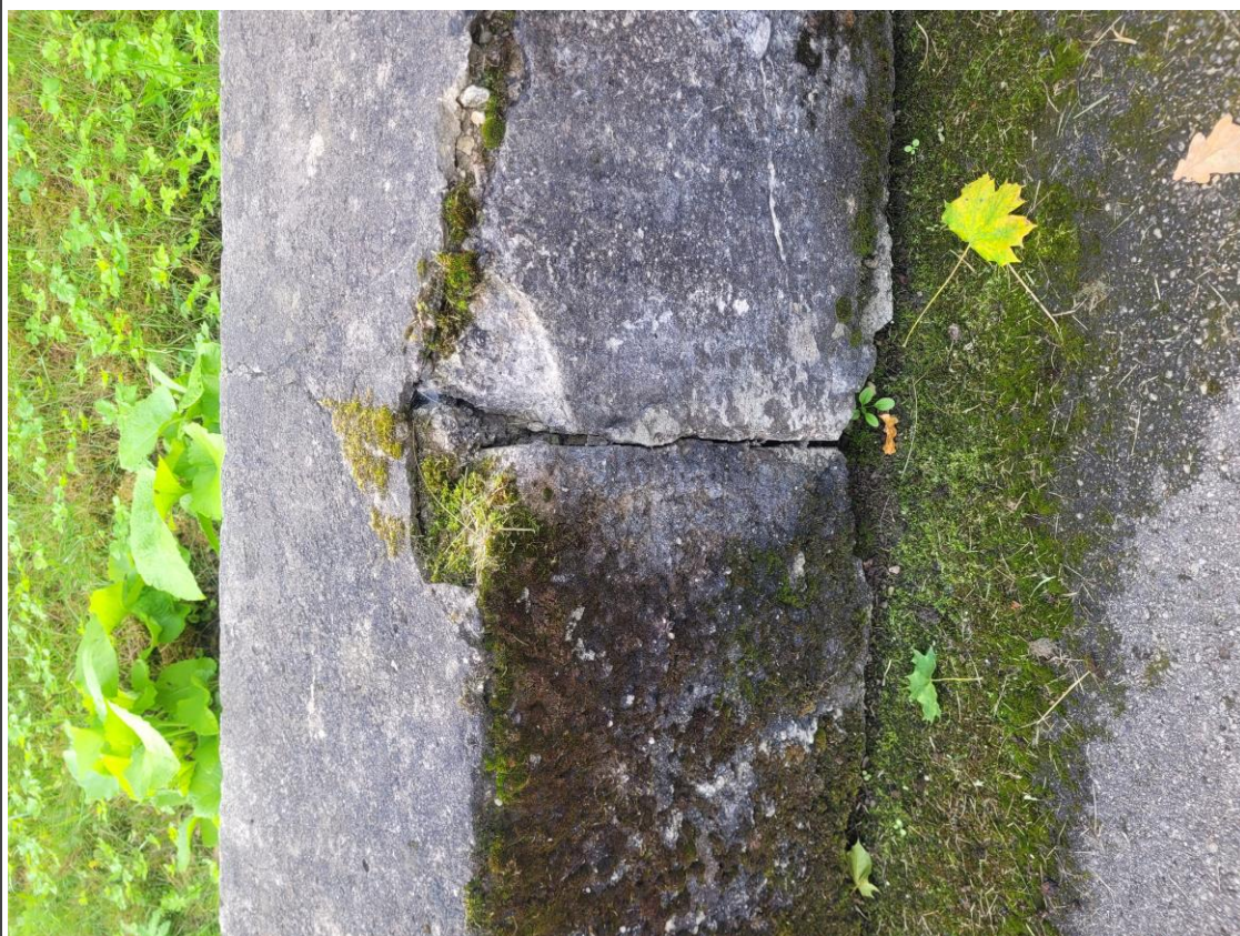
8.attēls. Atbalstsienas pie Talsu 2. vidusskolas, dzelzsbetona bloku šuvu vietās ir plaisas.
