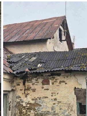
Bojātas ēkas piebūves konstrukcijas
