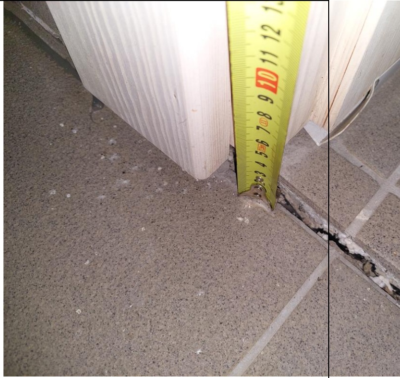
11. attēls (Grīdas uz grunts nosēduma augstums - 30÷40mm, skatīt p.nr.3 telpas plānā)
