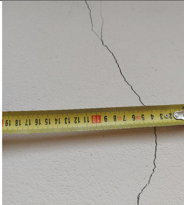
20. attēls (Plaisas dažāda pamatu līmeņa sienās 1÷2mm, skatīt foto Nr.14÷25, skatīt p.nr.5,6 telpas plānā)
