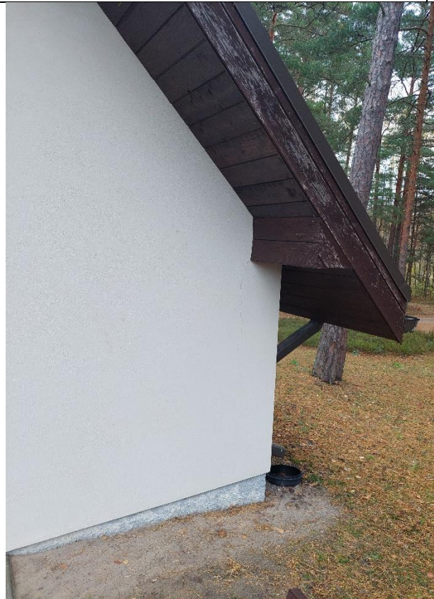
16. attēls (Plaisas nesošo sienu vietās zem mūrlatām, skatīt foto Nr.14÷25, skatīt p.nr.5,6 telpas plānā)
