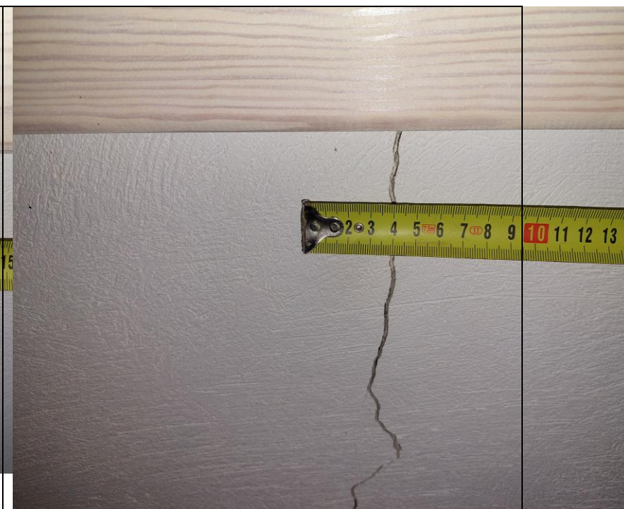
15. attēls (Plaisas dažāda pamatu līmeņa sienās 1÷2mm, skatīt foto Nr.14÷25, skatīt p.nr.5,6 telpas plānā)
