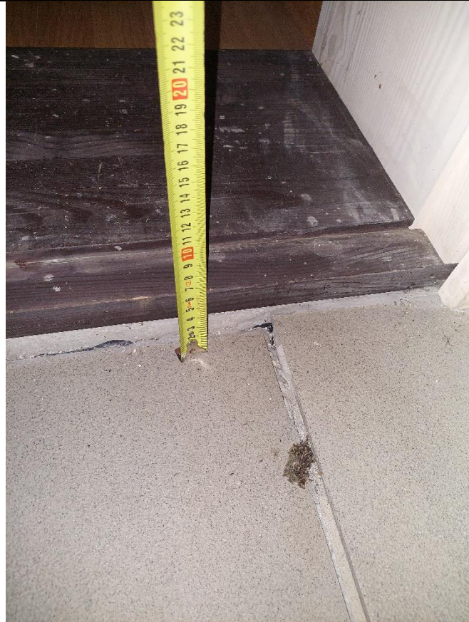
04. attēls (Grīdas uz grunts nosēduma augstums - 30±40mm, skatīt p.nr.3 telpas plānā)
