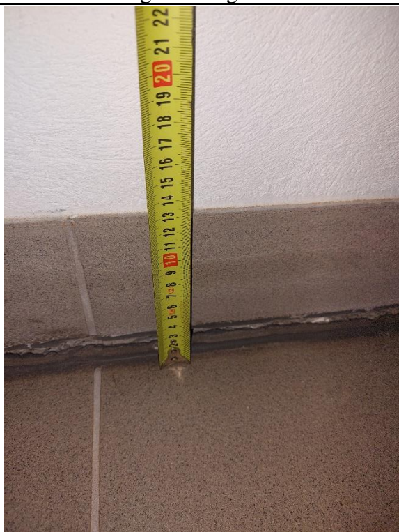
02. attēls (Grīdas uz grunts nosēduma augstums - 30÷40mm, skatīt p.nr.3 telpas plānā)
