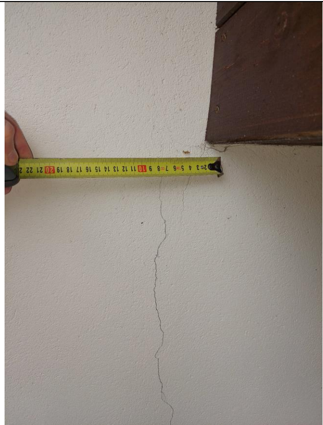
17. attēls (Plaisas nesošo sienu vietās zem mūrlatām, skatīt foto Nr.14÷25, skatīt p.nr.5,6 telpas plānā)
